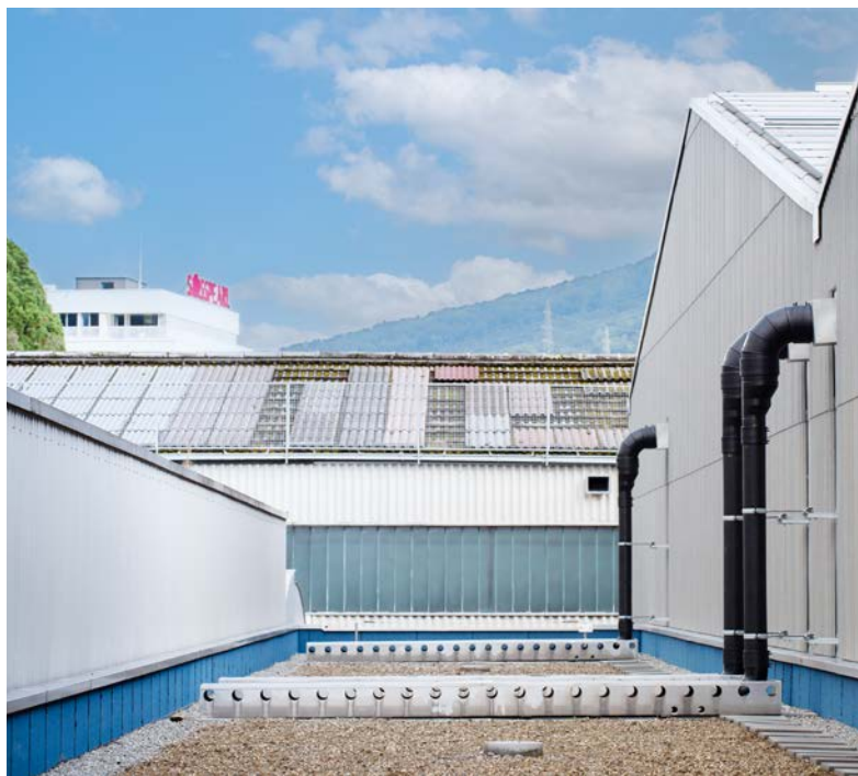
↑ Das Wasser vom Dach landet auf einem als Retentionsbecken konzipierten Zwischendach.
